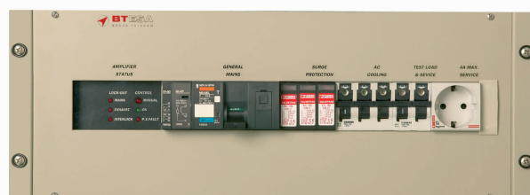
Sistema de protección y distribución de energía
